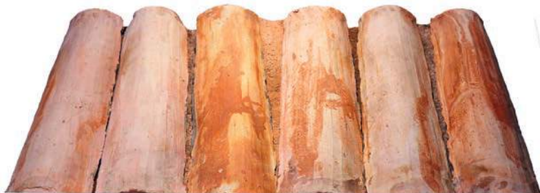
Tejas de la cubierta de la antigua fábrica de salazón Piñeiro, hoy integrada en el Museo Massó, siglo XIX
